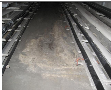
배수콘크리트 구배불량 (STA. 920m~940m)
