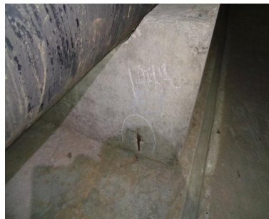
상수관 기초콘크리트 철근노출
