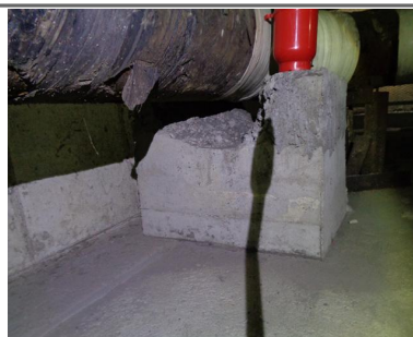
상수관 기초콘크리트 시공불량
