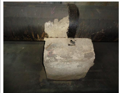
상수관 기초콘크리트 박락
