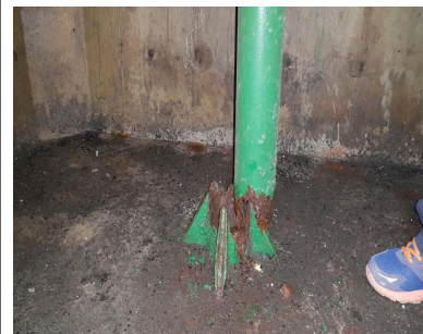
#19 철재계단 노후/지지대 파손
