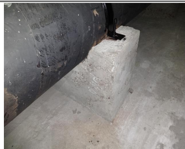
상수관 기초콘크리트 재료분리
