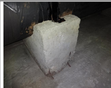
상수관 기초콘크리트 철근노출
