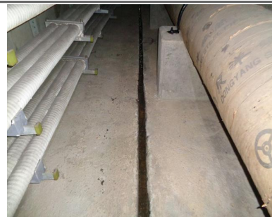
전력구 배수로 체수 (STA. 260m~520m)
