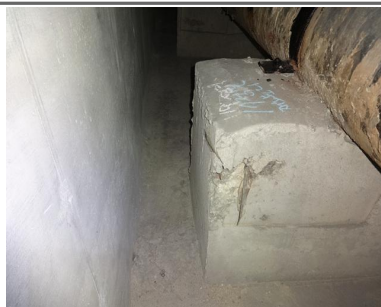
상수관 기초콘크리트 재료분리
