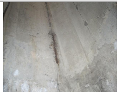
#43 수직구 벽체 철근노출
