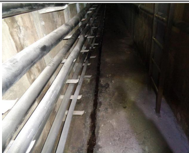
통신구 배수로 체수 (STA. 260m~500m)
