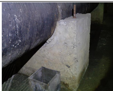
상수관 기초콘크리트 재료분리
