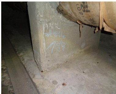
상수관 기초콘크리트 재료분리
