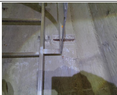
#32 수직구 벽체 철근노출
