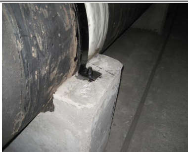
상수관 기초콘크리트 들뜸
