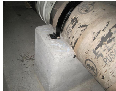
상수관 기초콘크리트 들뜸
