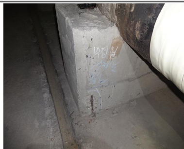
상수관 기초콘크리트 철근노출
