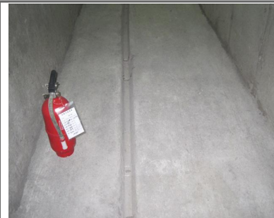
전력구 배수로 철근노출 (STA. 2,040m~2,200m)
