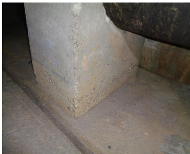
상수관 기초콘크리트 재료분리
