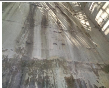
#20 수직구 벽체 철근노출
