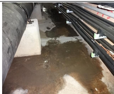
배수콘크리트 체수 (STA. 1,730m~1,740m)
