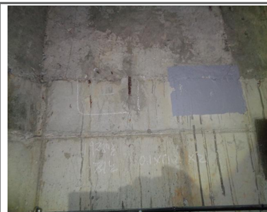
#34 수직구 벽체 철근노출
