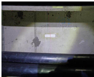
Sta.320~340m Type ② 균열 0.3/2.4
