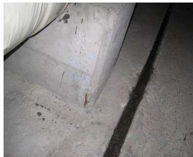
상수관 기초콘크리트 철근노출
