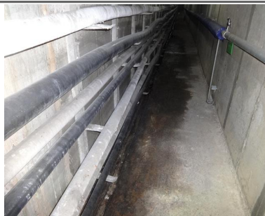
통신구 배수로 체수 (STA. 260m~500m)
