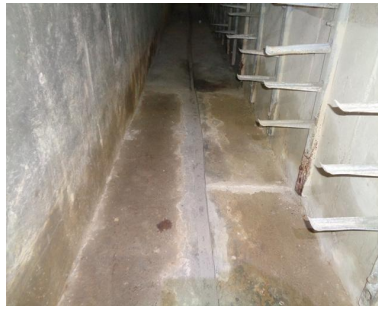
상수구 배수로 구배불량 (STA. 0m~20m)
