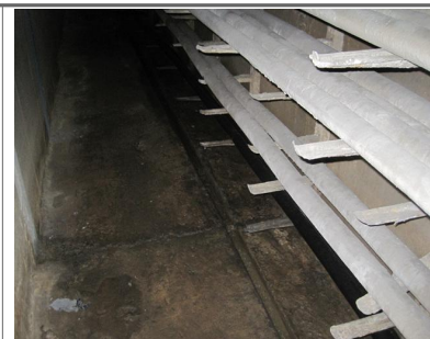
배수콘크리트 체수 (STA. 2,200m~2,280m)
